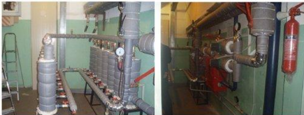
Установка системи теплопостачання з електронагрівачами електродного нагріву в «Інституті надтвердих матеріалів ім. В.Н.Бакуля НАН України» дозволило скоротити витрати на опалення адміністративного корпусу (4 700 м.кв) більш ніж на 50%.
